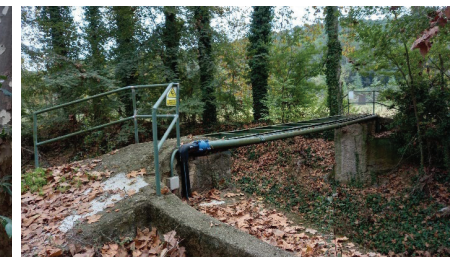
Figura 11 Passera amb serveis obsolets a la zona 6 Can Costa
