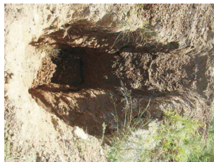
06- Vista de la cala C3
