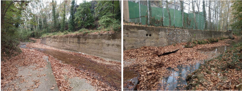
Figura 29. Imatges de les estructures a retirar a la zona del gual de Can Costa
