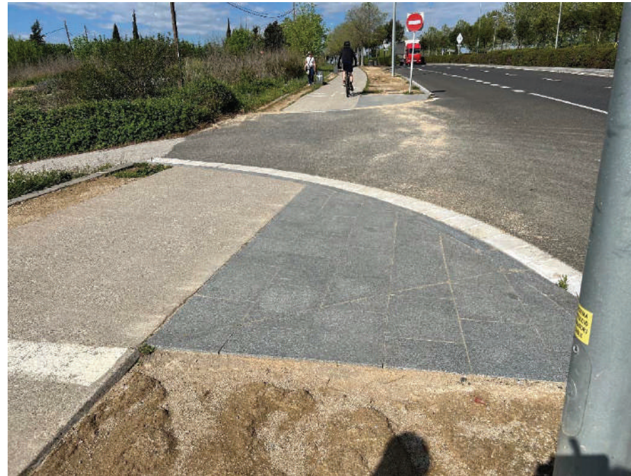
Afectació accés existent
