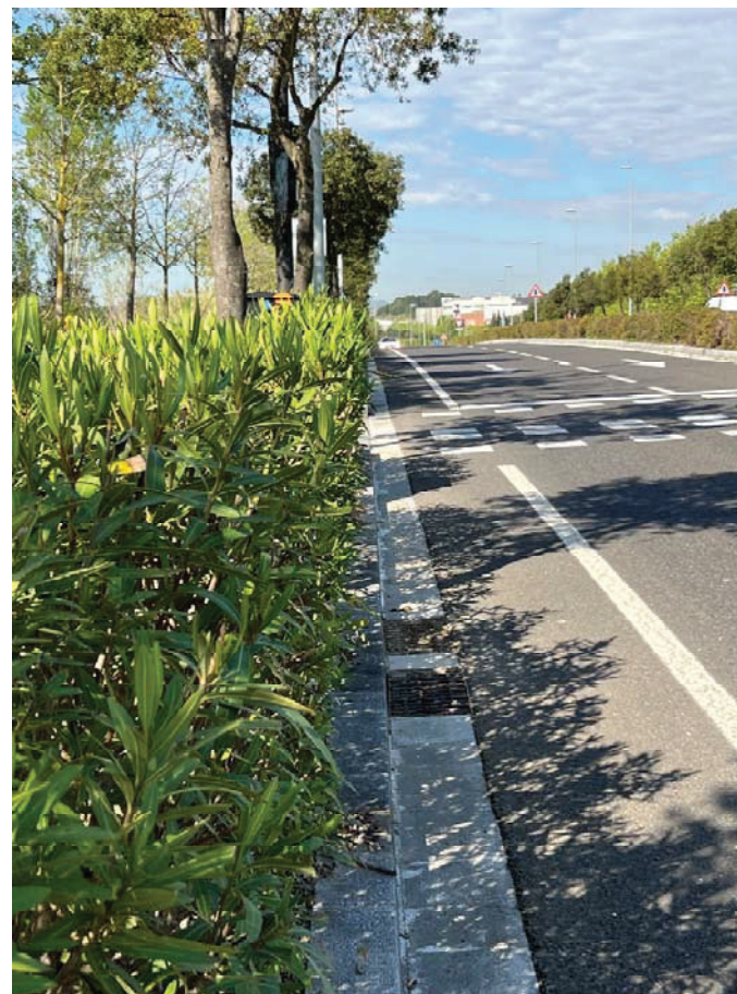
Afectació embornals carretera
