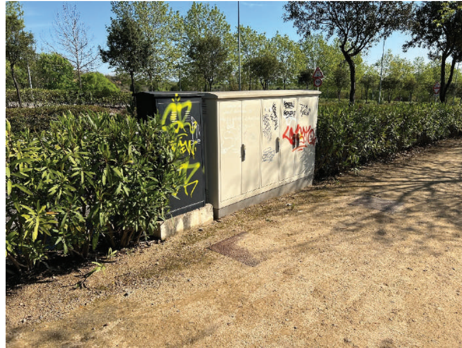
Quadre elèctric i de semàfors afectats
